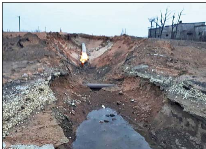
Po wybuchu gazociągu w ziemi pozostała ogromna wyrwa.
