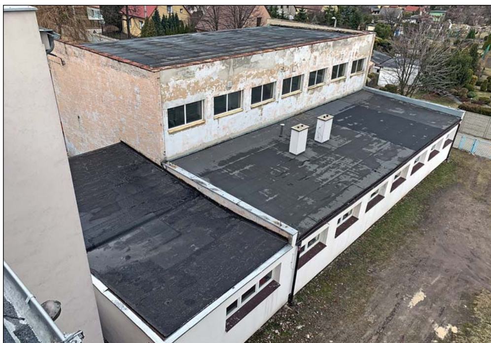
Ciekny dachy budynków OREW w Bytomiu.
